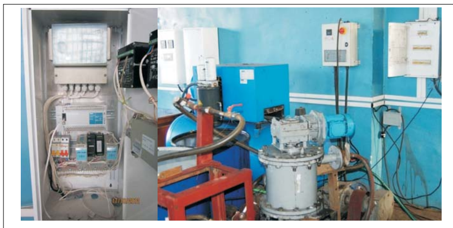
Рис. 1. Экспериментальный стенд и система управления теплогенератором
